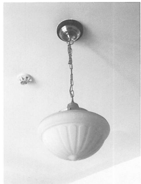
20 1号室への通路右手・給湯室の ペンダント
